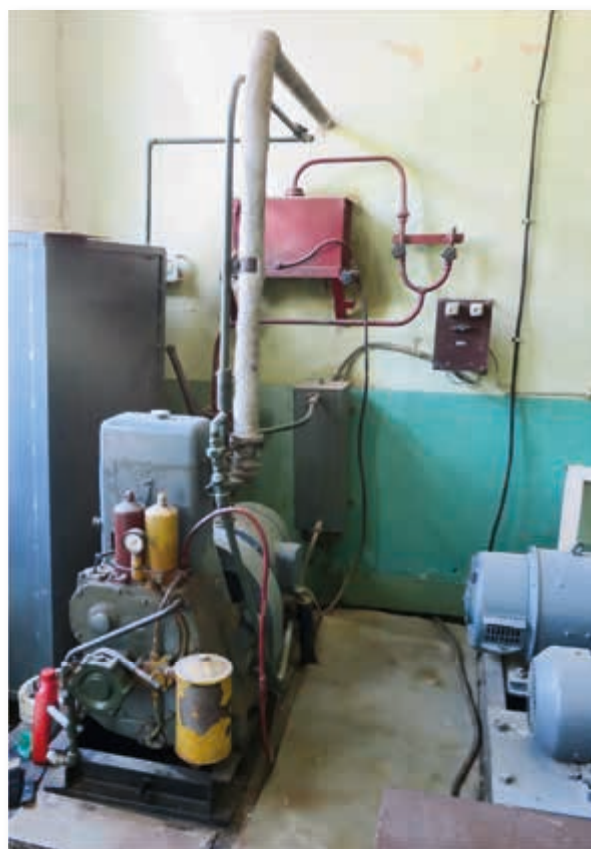
Ако електрозахранването прекъсне, в действие влиза дизел-генераторът 14А, произведен през 1950 г., 2016 г.
